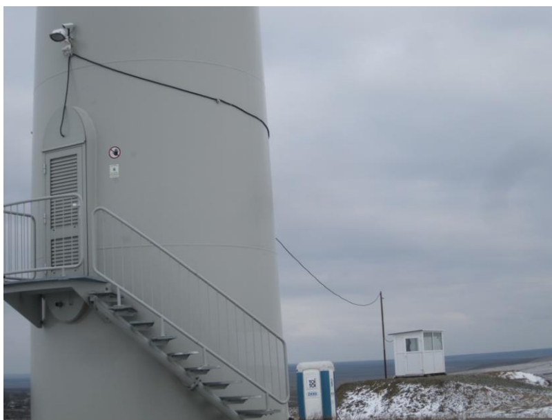
Foto 1. Cabina pentru paznici, grup sanitar ecologic si container pentru deseuri menajere (amplasat in interiorul cabinei)
