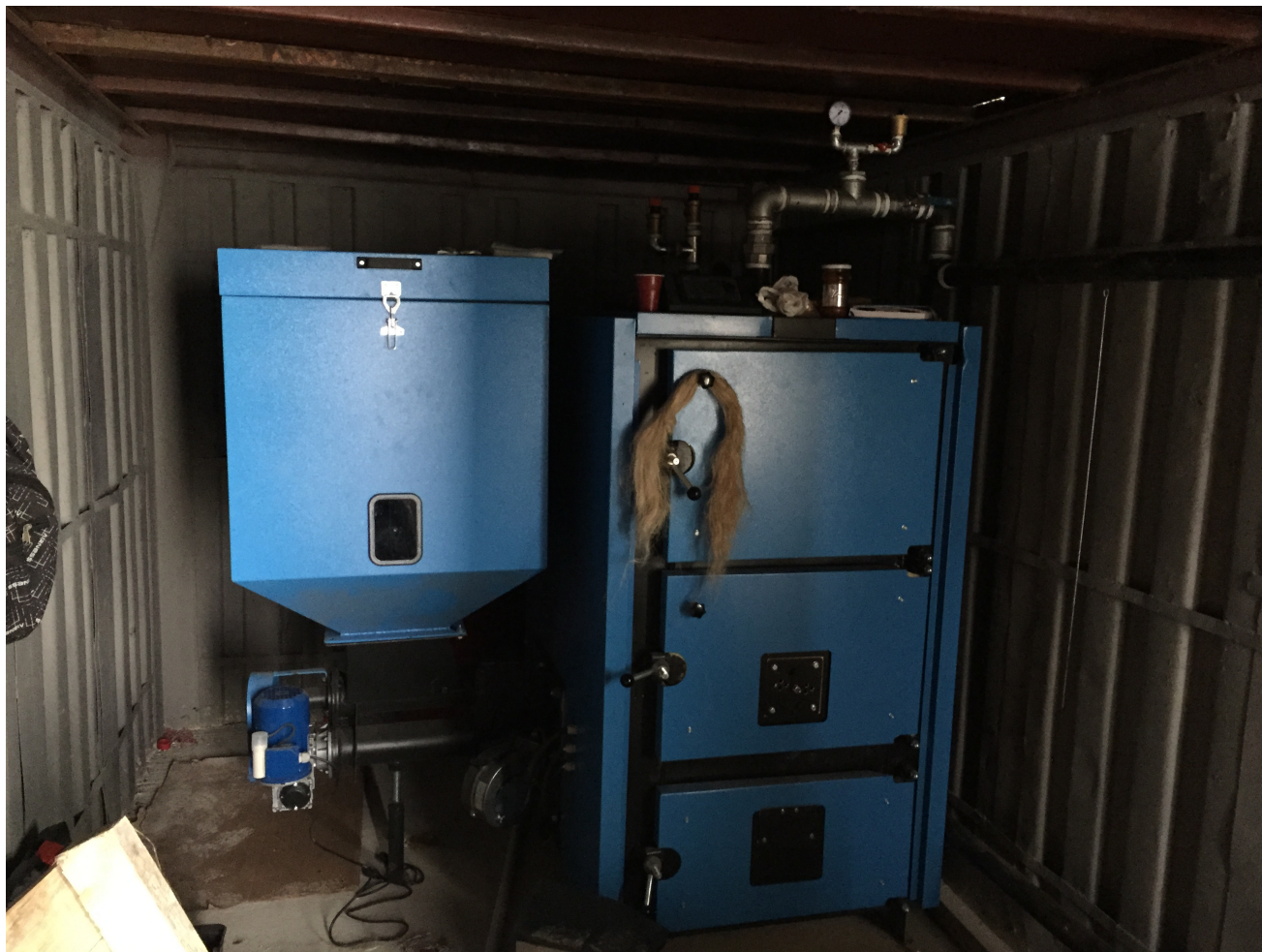
Centrala termica ce deserveste hala nr.3
