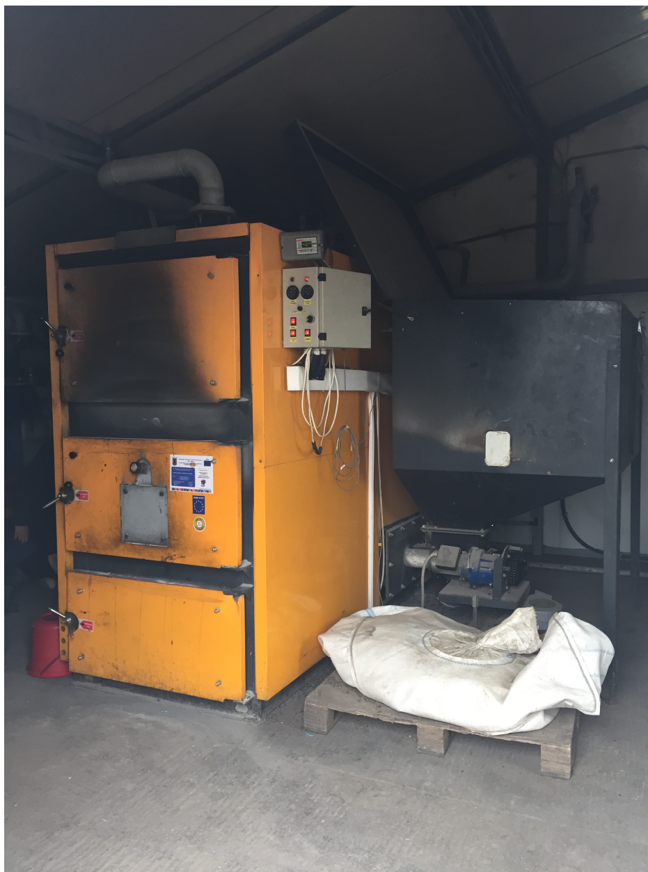
Centrala termica ce deserveste halele 1 si 2
