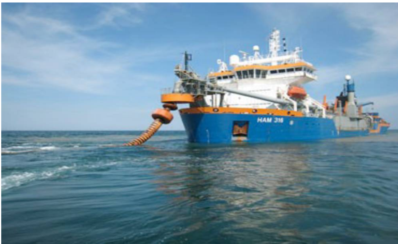
Draga TSHD HAM 316 în timpul operațiunii de pompare la țărm prin conducte ( https://www.dredgepoint.org/dredging-database/equipment/ham-316 )
