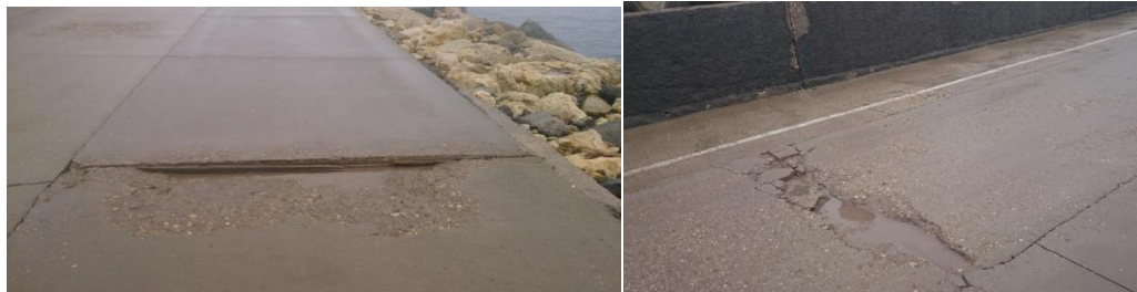
Fig.7 Secțiuni deteriorate a coronamentului Dig de Larg, Port Constanta ( foto : D.Craciun)
