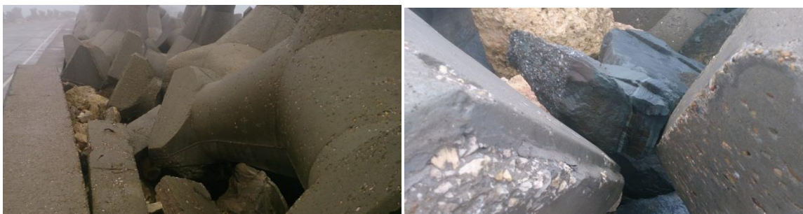
Fig.5 Caverne in mantaua de protectie, Dig de Larg Port Constanta ( foto : D.Craciun)
