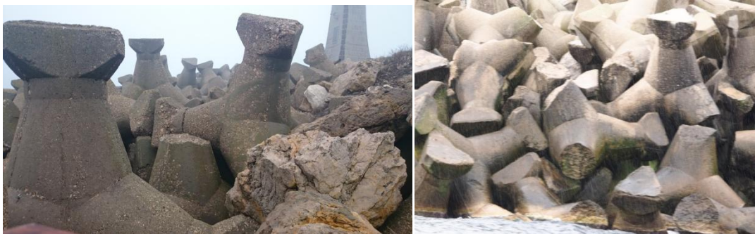
Fig.3 Stabilopozzi rupti, Dig de larg Port Constanta ( foto : D.Craciun)
