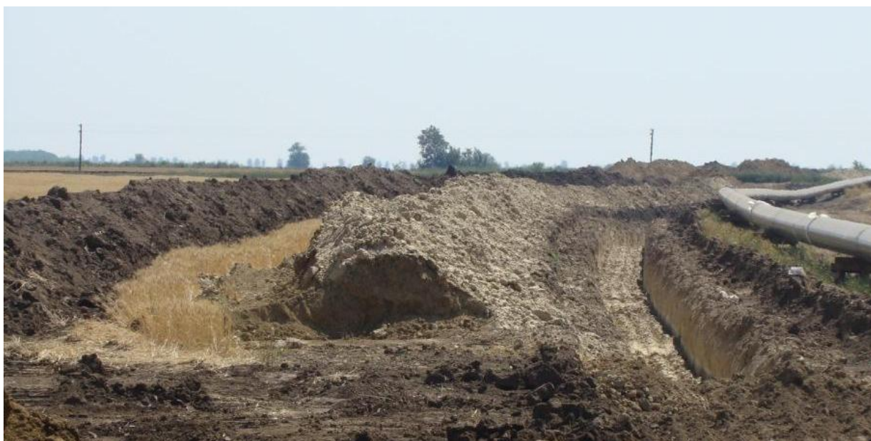
Fig.1.II. Aspectul unui culoar de lucru pentru amplasarea unei conducte de transport gaze naturale
