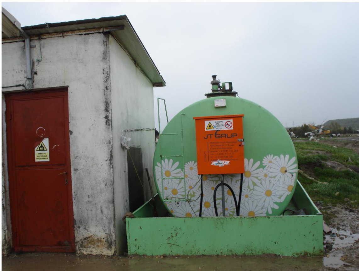
Fig.7 - Statie alimentare cu carburant
