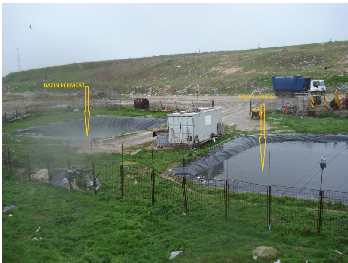
Fig.13 - Incinta statie de epurare
