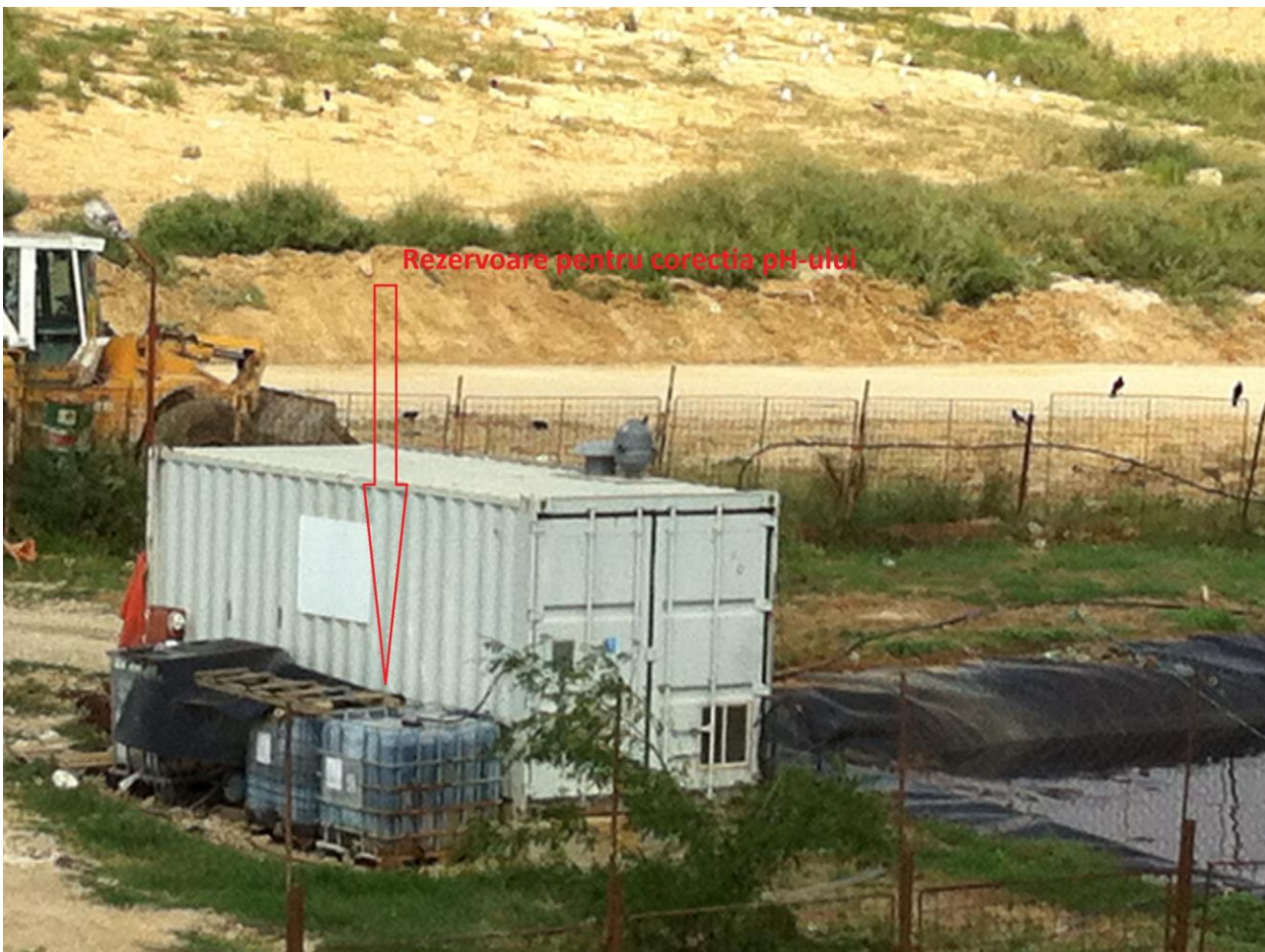
Fig.22 - Statie de epurare monobloc, cu osmoza inversa – Rezervoare pentru corectia pH-ului
