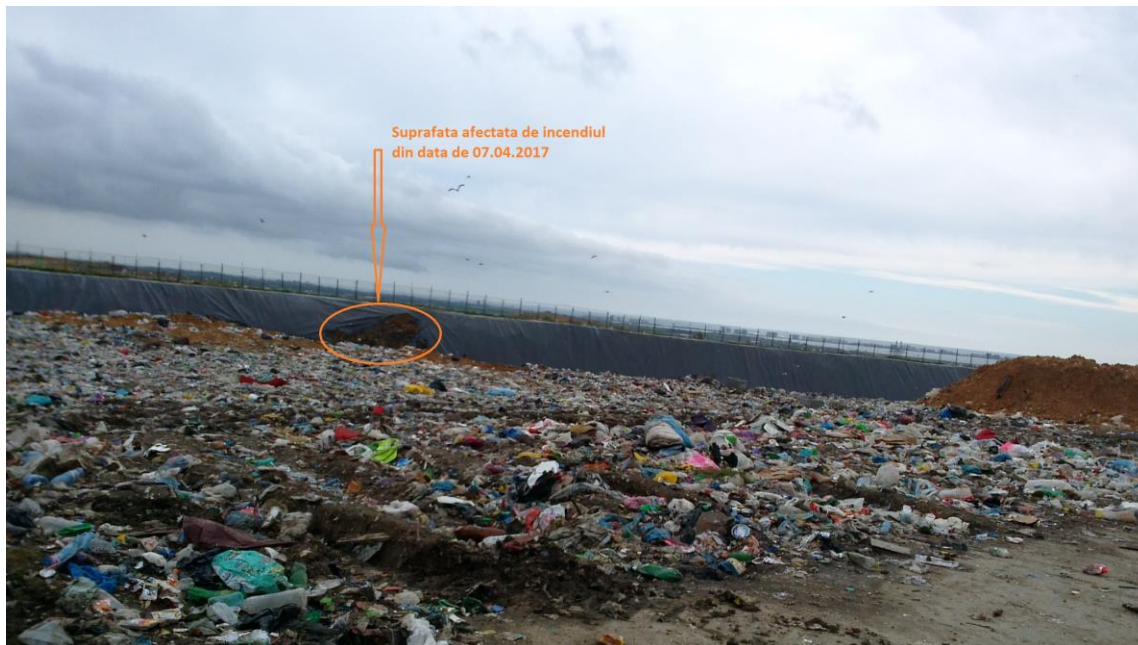
Fig.17 - Geomembrana celulei VI afectata de incendiul din data de 07.04.2017
