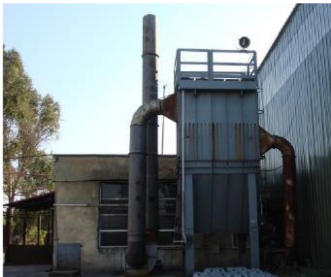
Fig.9 Instalatie de filtrare uscata a gazelor IFG4
