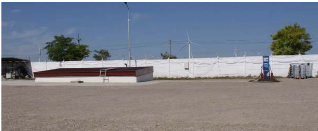
Rezervor cu motorina ingropat si pompa alimentare carburant
