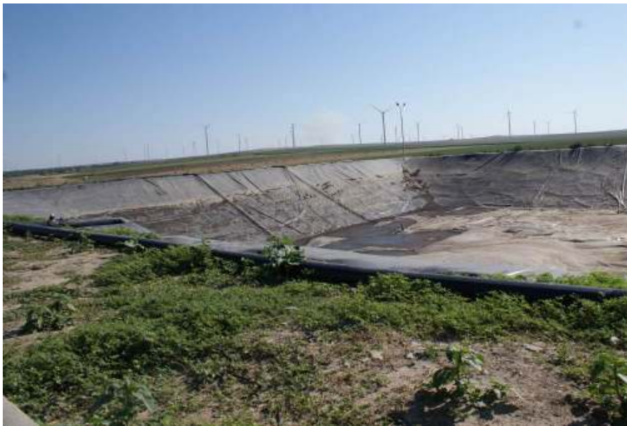
Aspect al unei lagune cu membrana geotextila de pe amplasament
