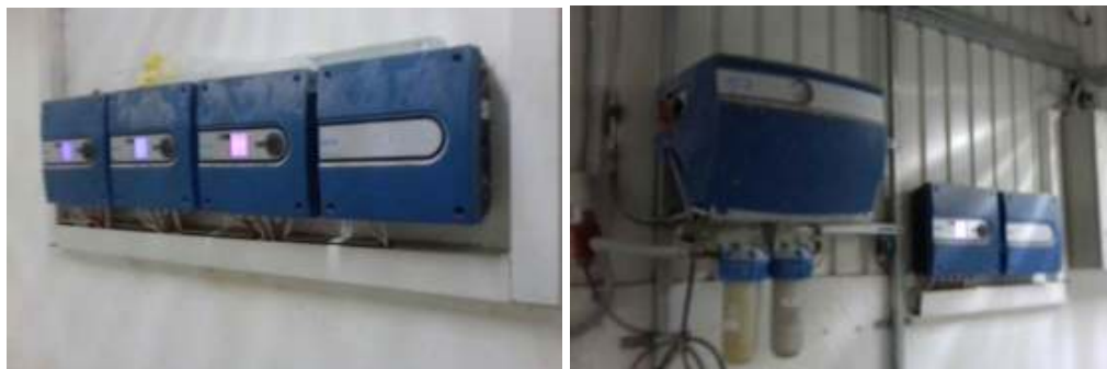
Panouri de control de pe holurile tehnologice
