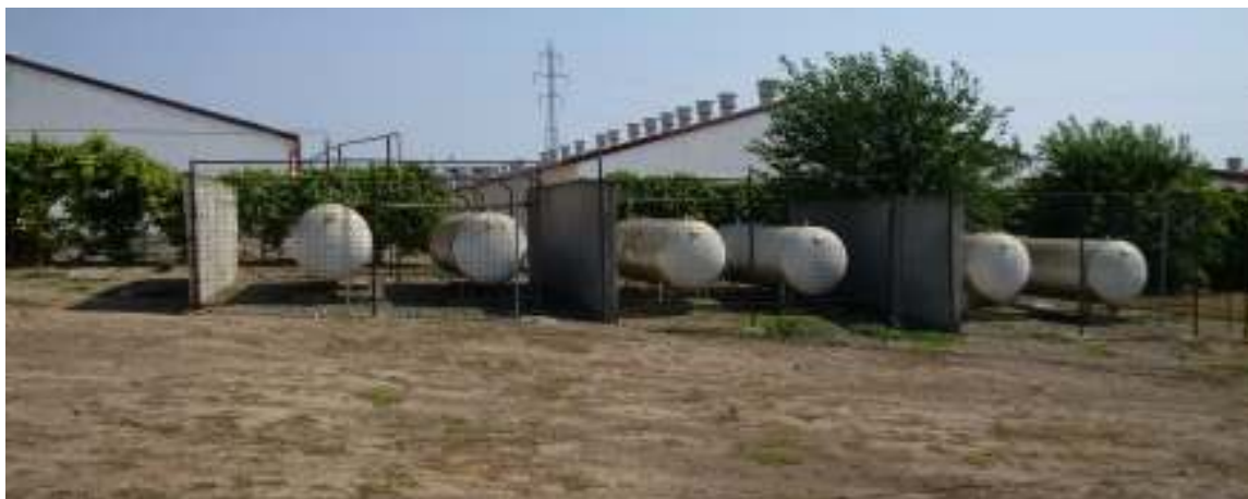
Rezervoare GPL depozitate pe amplasament
