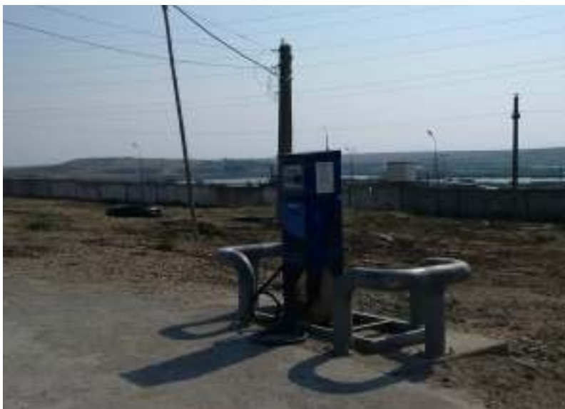
Platforma betonata si pompa livrare combustibil
