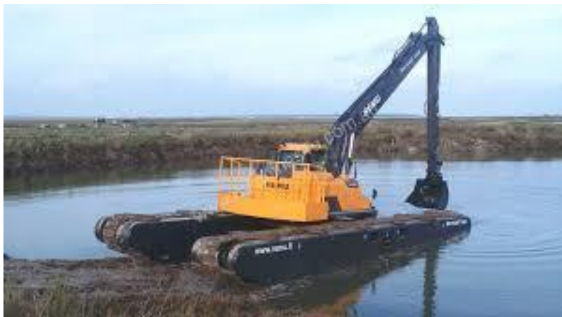
Foto 4: Săparea șanțului pentru traversare Balta Mare și Balta de Mijloc cu excavator clasic (pentru adâncimi mici ale apei)
