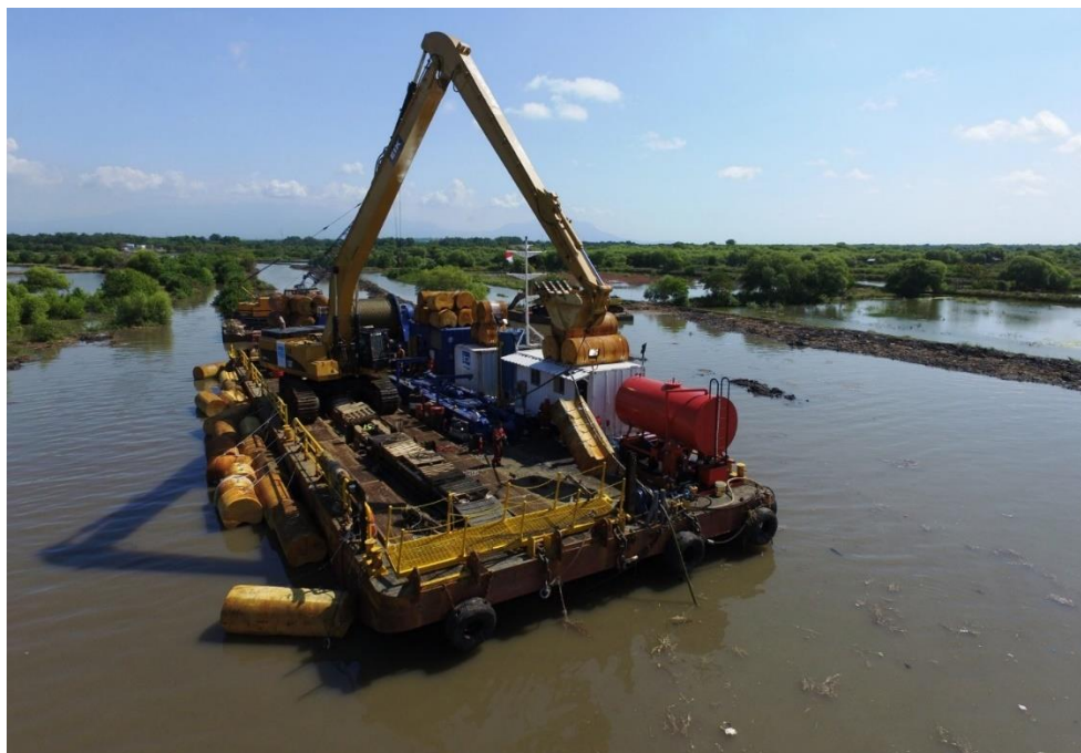
Foto 5: Săparea șanțului pentru traversare Balta Mare și Balta de Mijloc cu excavator plutitor (pentru adâncimi mari ale apei)
