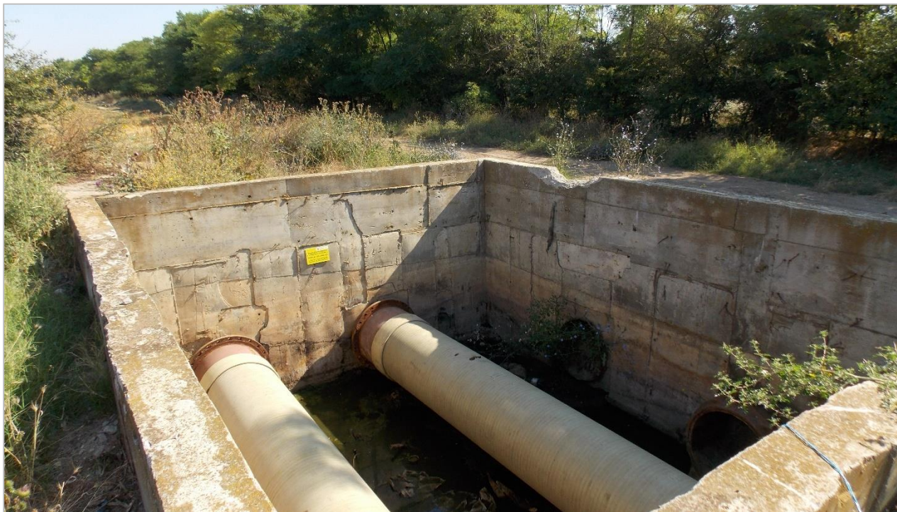
Foto 12: Cămin conducte ape uzate aparținând ROMPETROL RAFINARE, aflate în imediata vecinătate a amplasamentului înspre sud-est
