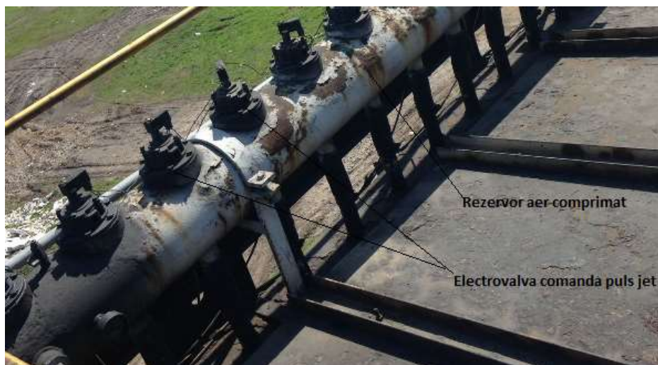
Instalatie de filtrare – imagine zona superioara a filtrului
