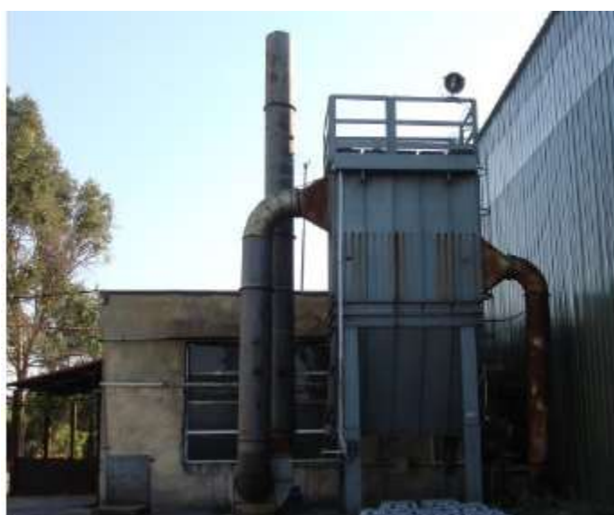
fig.9 Instalatie de filtrare uscata a gazelor IFG4
