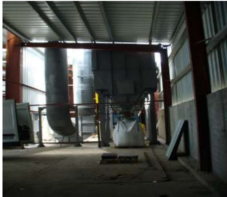
fig.8 Instalatie de filtrare uscata a gazelor IFG5
