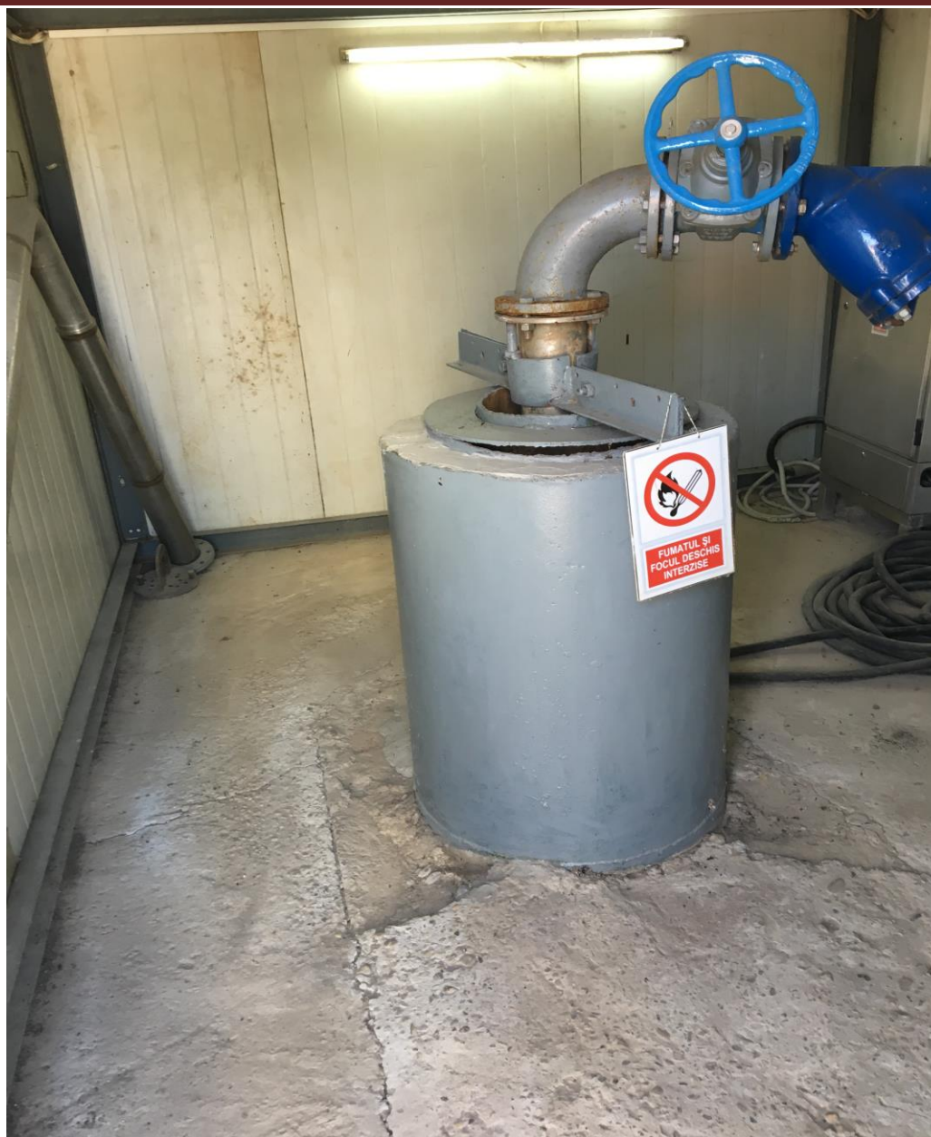
Foto 18. Cabina de protectie si forajul de alimentare cu apa (FH3)
