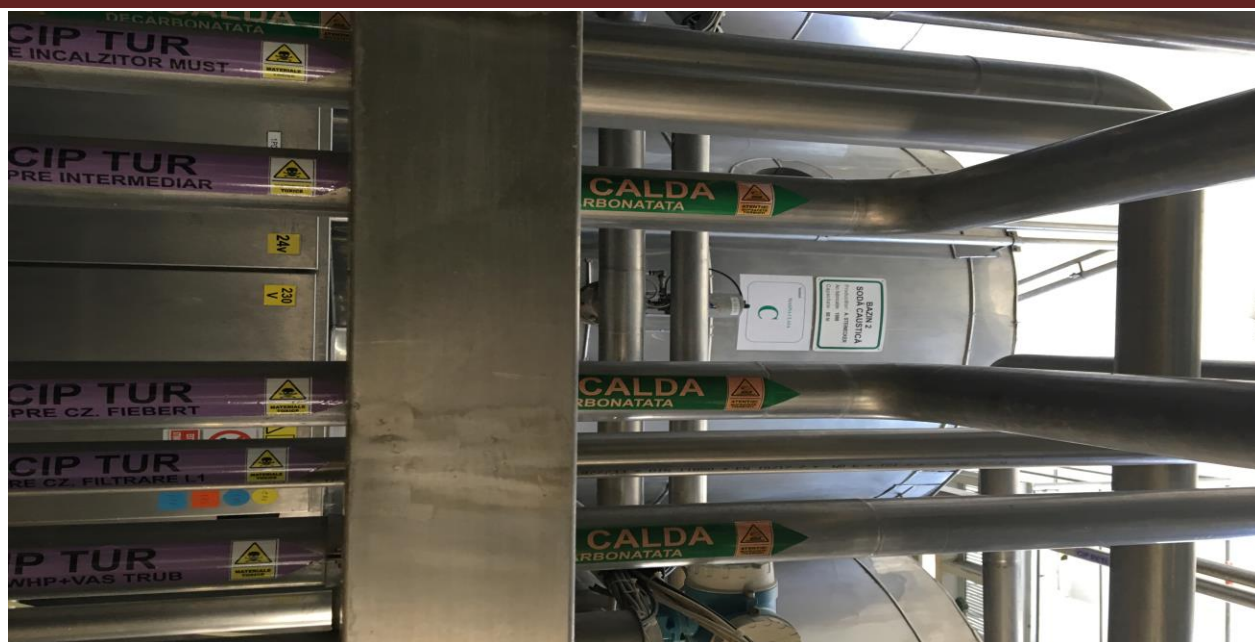
Foto 9. Componente ale sistemul instalatiei CIP
