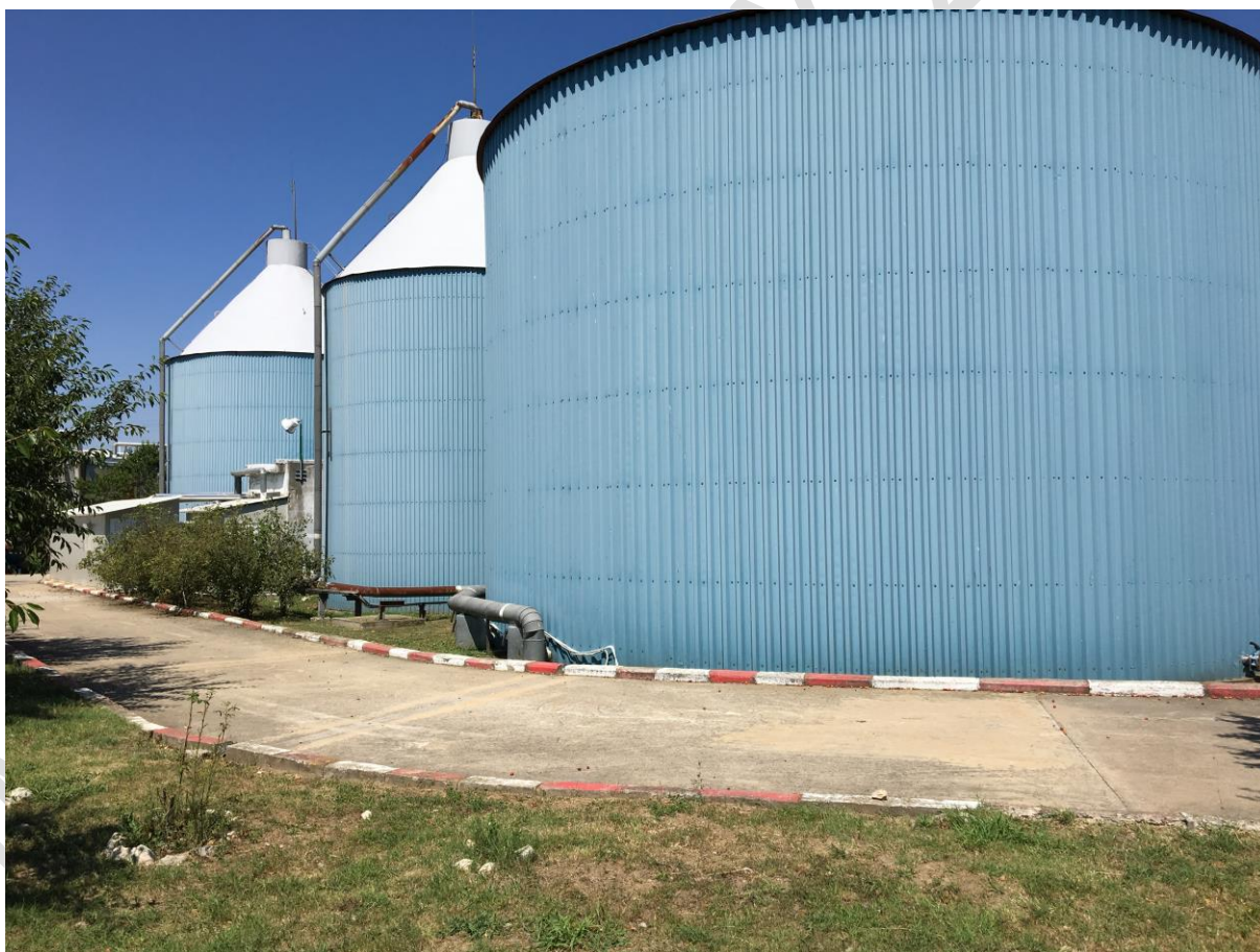
Foto 24. Componente principale ale statiei de epurare - reactoarele
