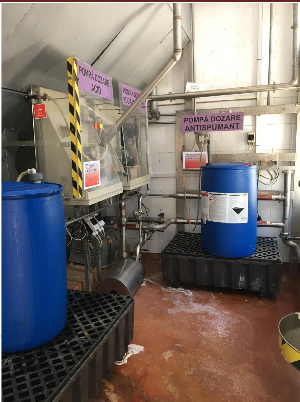
Foto 11. Sala preparare solutii pentru instalatia CIP
