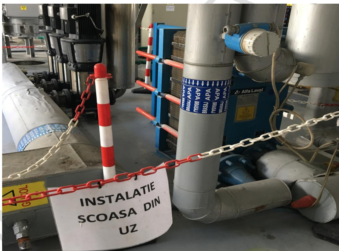
Foto 7. Centrala termica (interior)
