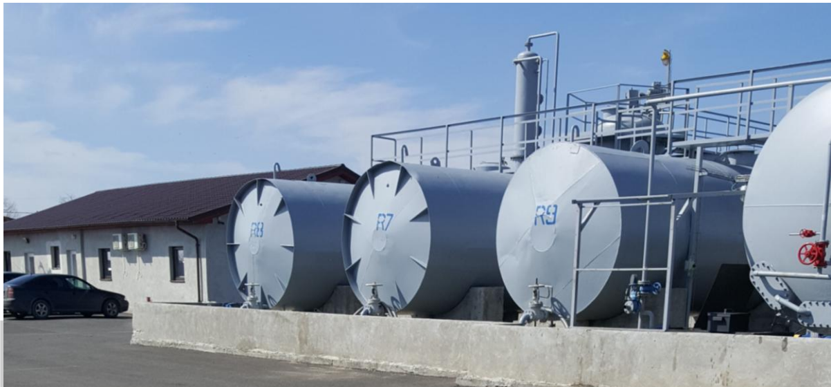
Foto 22. Rezervoarele R7 si R8 pentru ulei regenerat (ulei de baza) si rezervorul R9 (reziduu de vid, etc)
