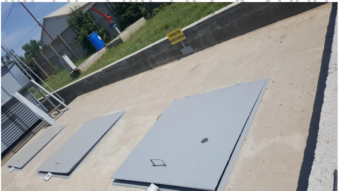
Foto 4 . Separator de hidrocarburi tricompartmentat
