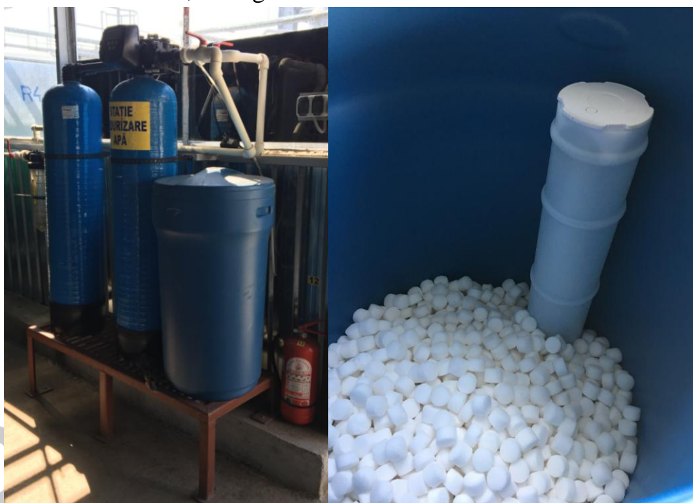
Foto 8. Instalatie dedurizare apa pentru abur tehnologic
