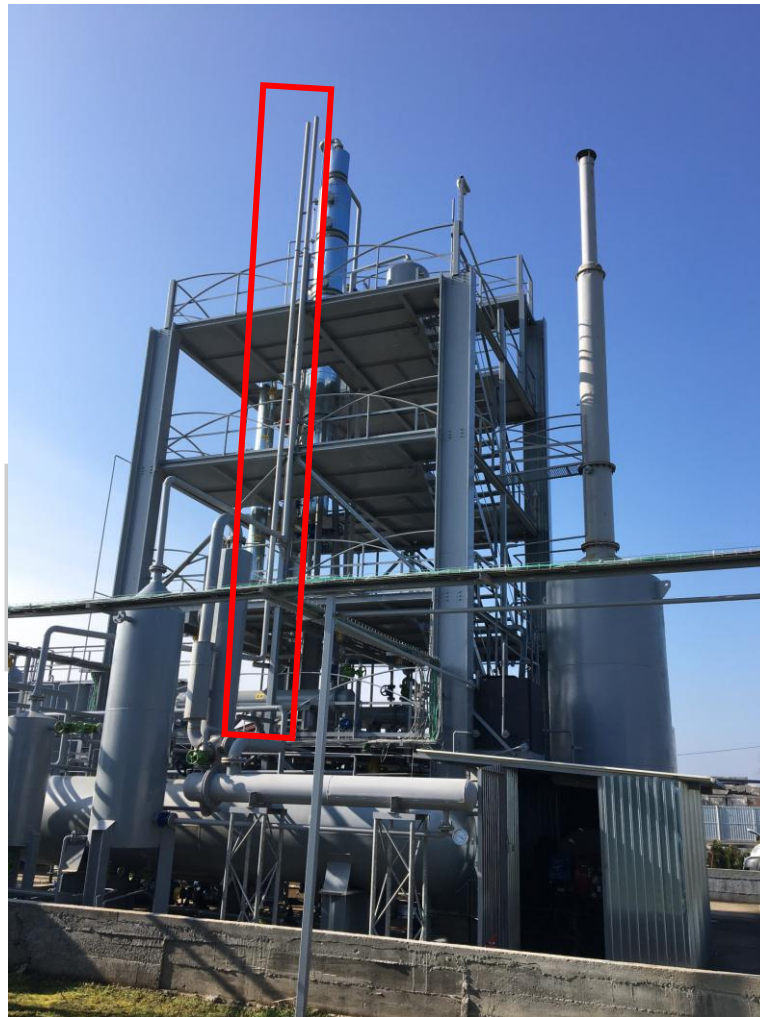
Foto 17. “Vent-uri “ ale instalatiei de distilare
