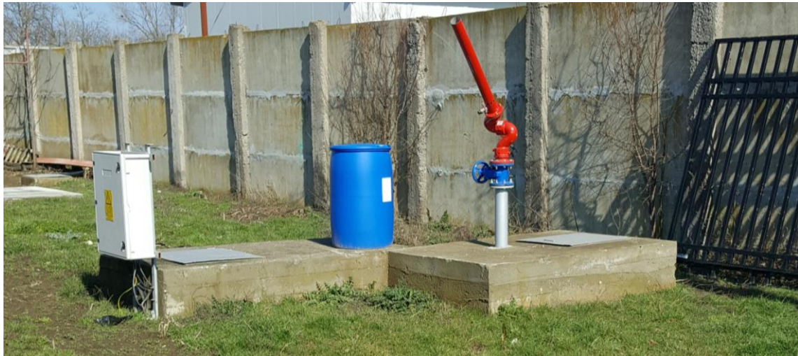
Foto 24. Platforma preluare apa PSI din bazinul subteran
