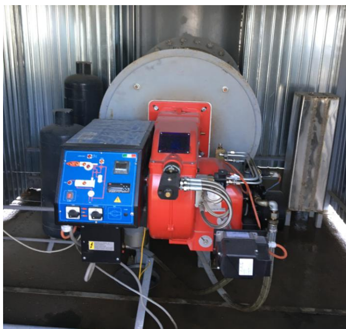
Foto 9. Arzator cuptor tehnologic
