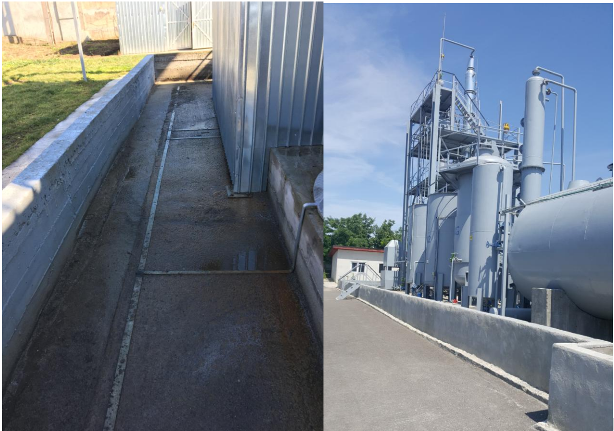
Foto 3. Cuva de retentie cu perete anti-debordare - platforma tehnologica
