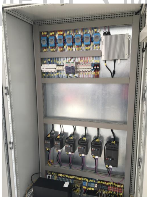
Foto 14. Panou de comanda pompe electrice
