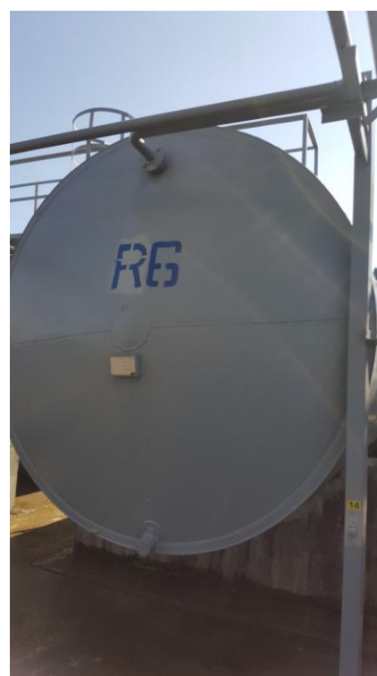
Foto 21. Rezervorul R6 pentru depozitare ulei Fractia II
