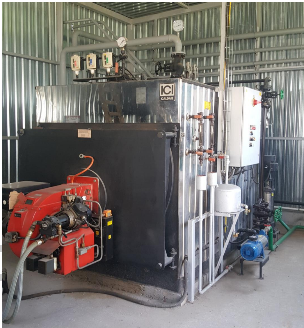
Foto. 5. Cazan producere abur tehnologic ICI CALDAIE
