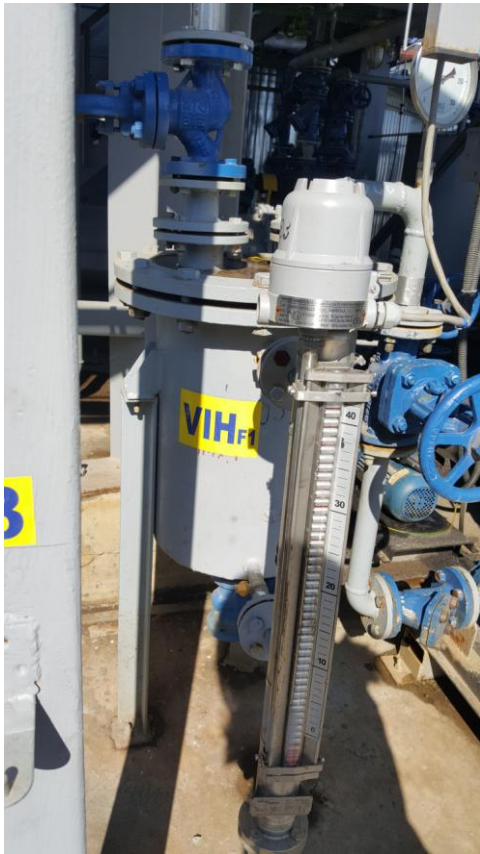
Foto 18. Priza laterala VIH F1 a coloanei de distilare pentru ulei Fractia I
