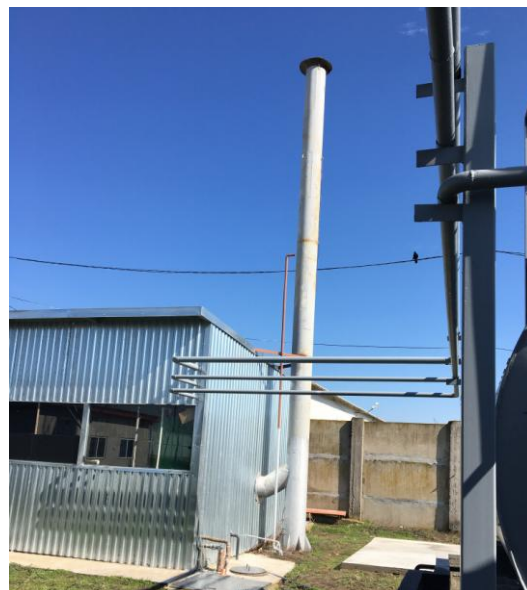
Foto 7. Cos centrala termica
