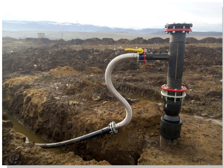
Figura 3 – Capul special de puț de gaz, record flexibil inox și conducta transportoare
