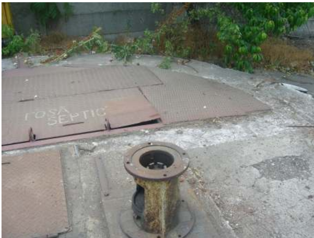
Foto 6 : bazinul de colectare ape uzate
