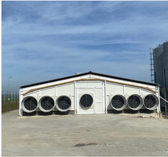
Fig.8 – Ventilatoare de fronton
