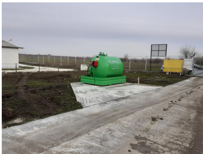
Fig.9 – Statie alimentare motorina
