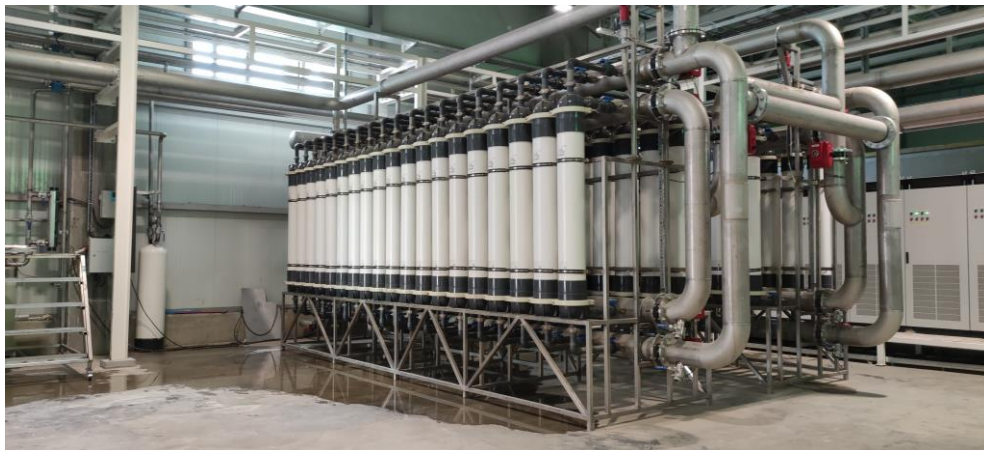
Foto 2: Zona tratare apa bruta
