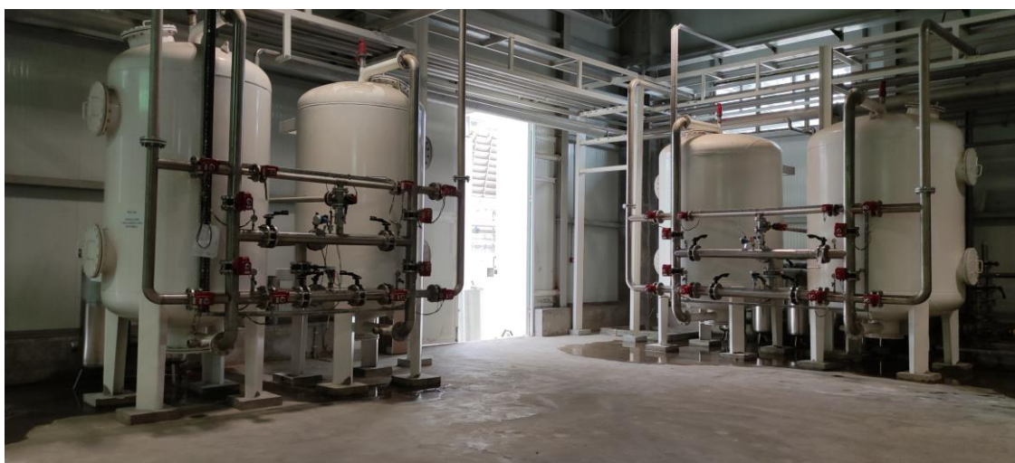
Foto 1: Zona tratare apa bruta
