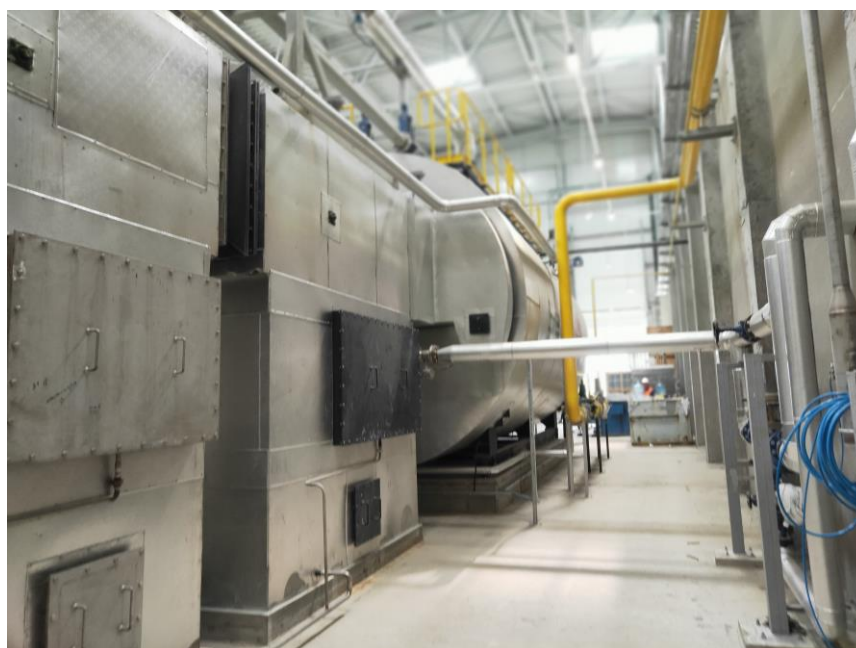
Foto: Incinta hala instalatie cogenerare
