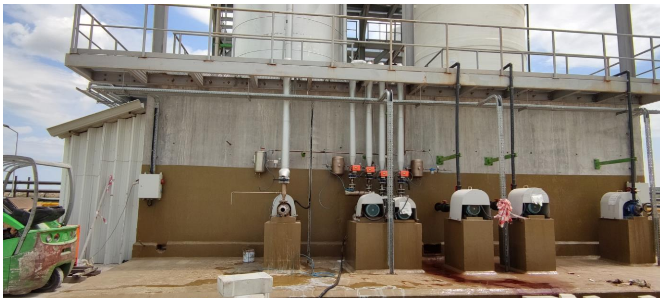
Foto 1: Zona rezervoare supratereane depozitare acide-caustice
