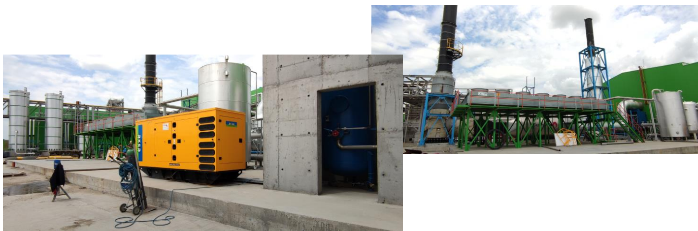
Foto: Zona instalatie de cogenerare
