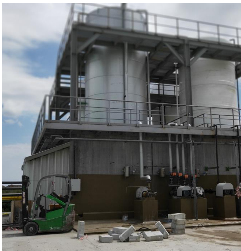
Foto: Rezervoare de acide-caustice
