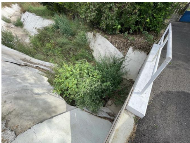
Colector Est – degradare taluzuri lângă podeț și depuneri aluvionare
