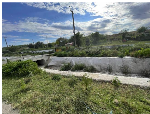
Colector SUD – degradat si colmatat
