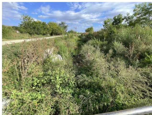
Deversor colmatat și geotextil dislocat
