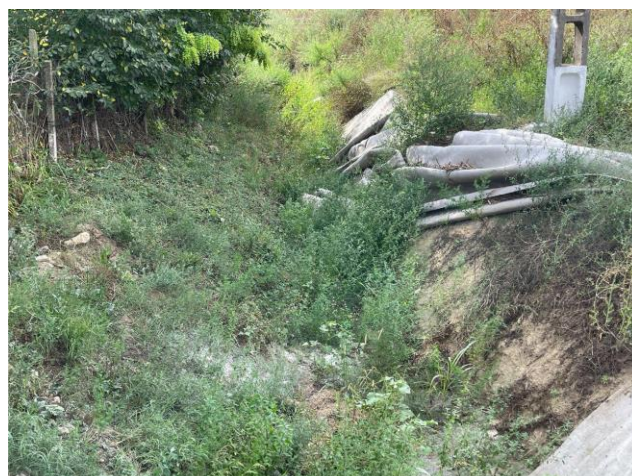
Colector Est – degradare majoră a canalului
