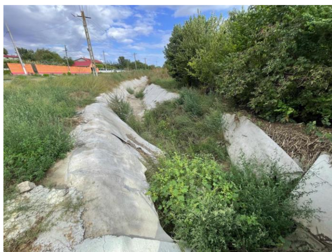
Colector Est – degradare taluzuri și depuneri aluvionare
