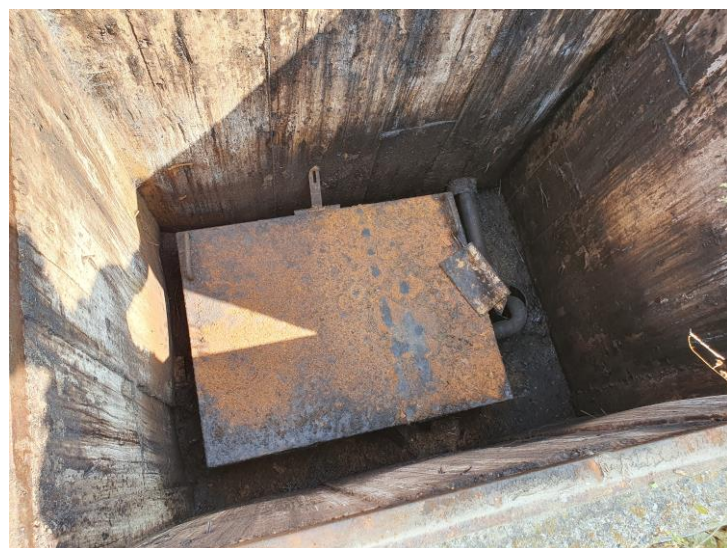
Camine de vizitare rezervor subteran si capac metalic gura vizitare
