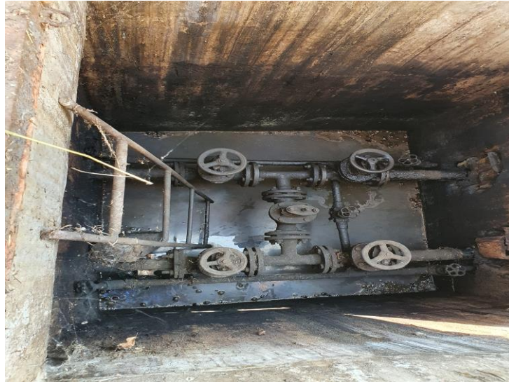
Camine de vizitare vane rezervoare subterane
