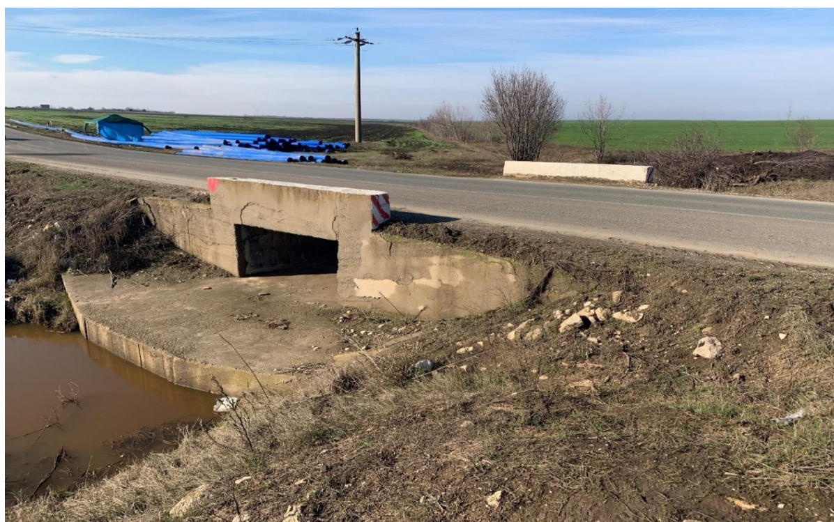
Secțiune de curgere subdimensionată și obturată – Tătlăgeacul Mare
