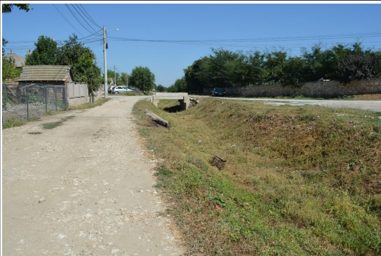
Podet subdimensionat - Tătlăgeacul Mare
