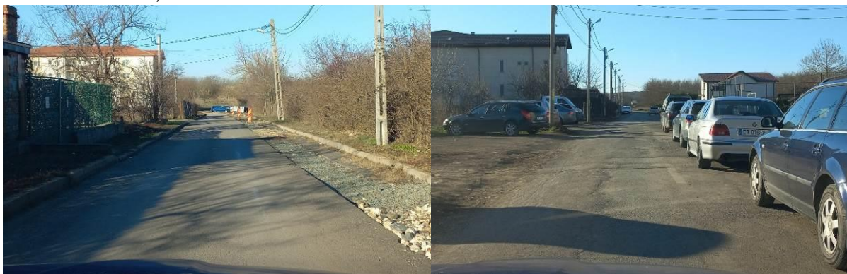
Sector asfaltat foarte degradat
