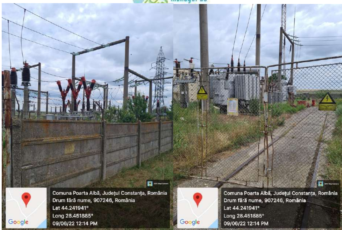
Figura nr. 2-12 Aspect asupra stației de transformare in care se va conecta PV Nazarcea
